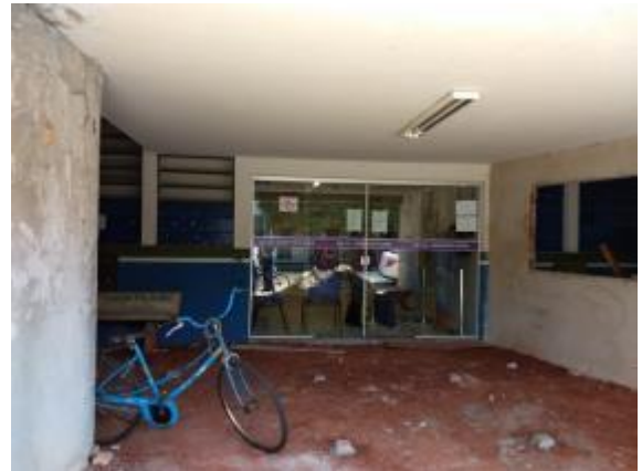
Acesso à farmácia obstruída:
