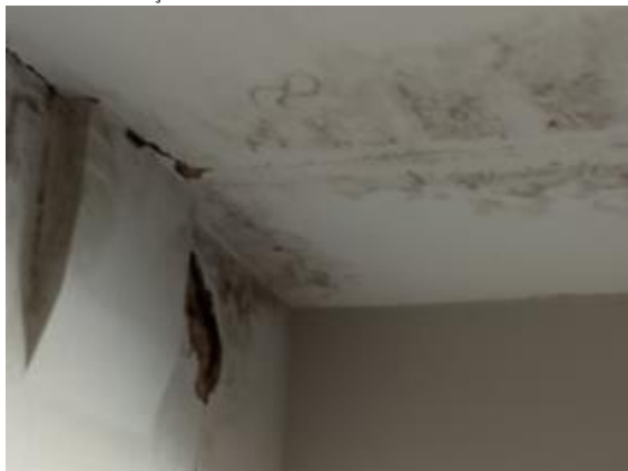
Infiltrações e rachaduras:
