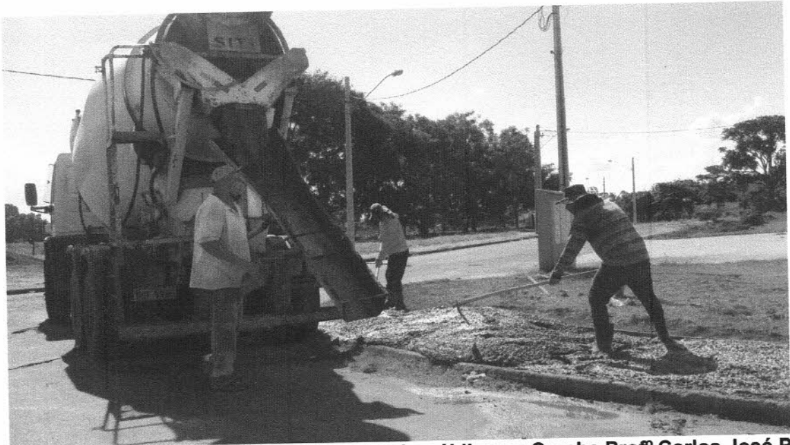
FOTO 14 – Processo de concretagem do passeio público na Creche Profº Carlos José Pereira
