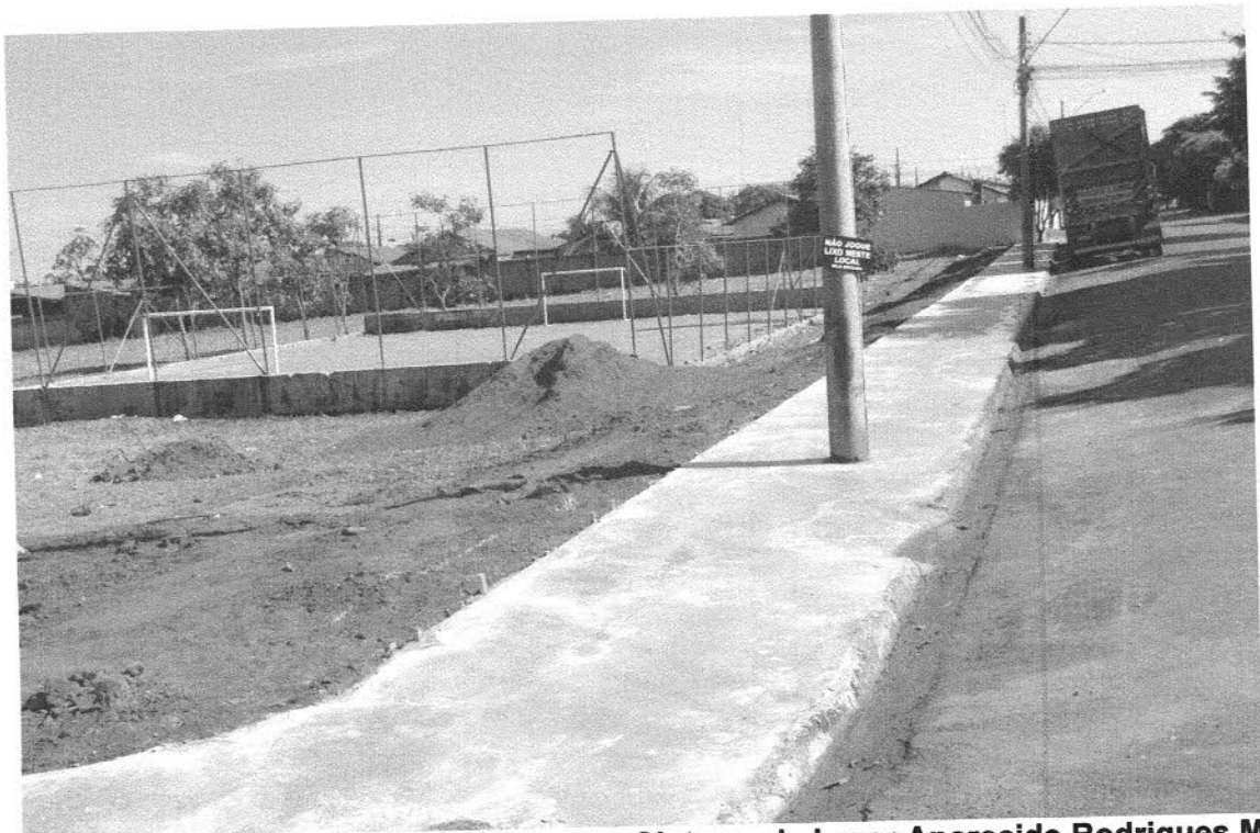
FOTO 21 – Processo de concretagem de passeio público no Sistema de Lazer Aparecido Rodrigues Moutinho – Rua Ayrton Senna.
