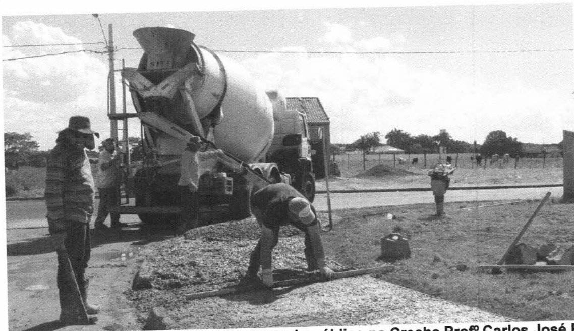
FOTO 15 – Processo de concretagem do passeio público na Creche Profº Carlos José Pereira.
