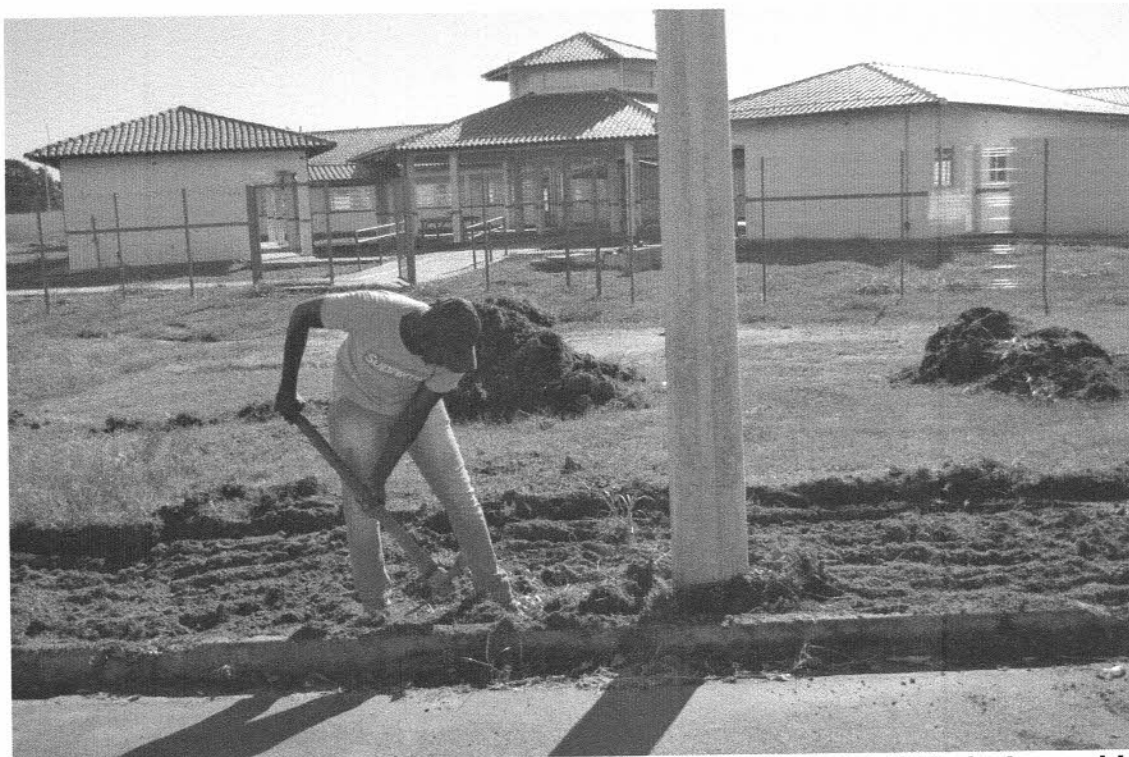
FOTO 09 – Processo de implantação de passeio público na Escola Profª Maria Aparecida Duarte
